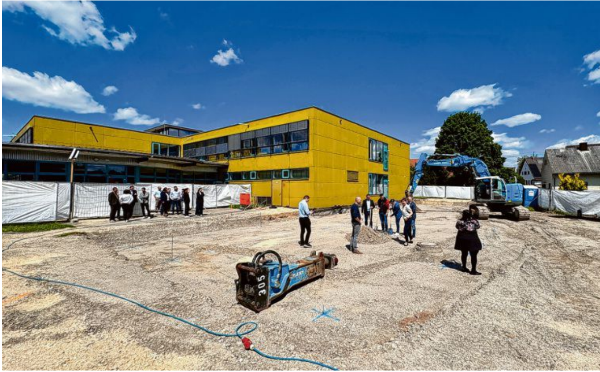
Hier wird in Gundelfingen ein moderner, zweistöckiger Anbau für die Nachmittagsbetreuung der Grundschule gebaut. Er soll rund 3,6 Millionen Euro kosten. Fotos: Philipp Scheuerl
